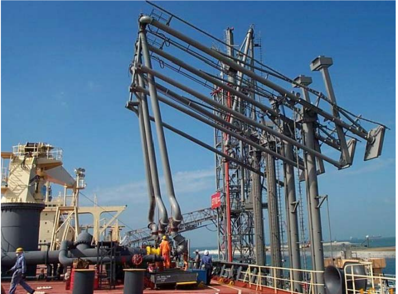
Brazos de carga/descarga conectados al manifold del barco. (Fuente: Bussinessleader.co.uk).
