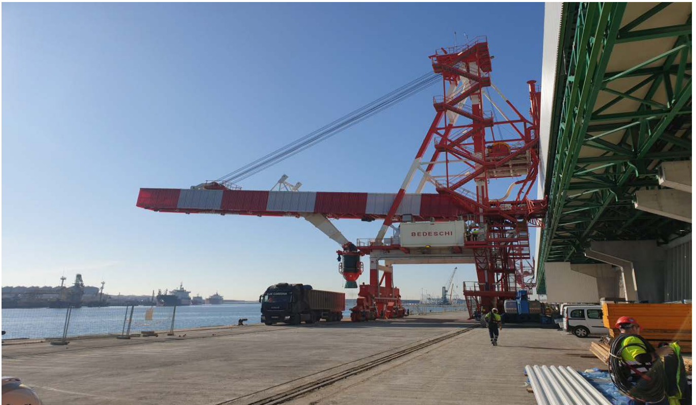
Cargador de buque continuo en la terminal ICL Iberia. Puerto de Barcelona. (Fuente: ICL Iberia).
