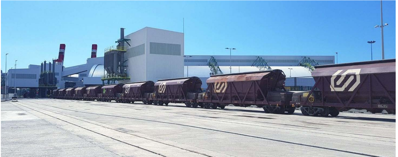
Instalación para la descarga de vagones de potasa en la Terminal ICL Iberia. Puerto de Barcelona. (Fuente: ICL Iberia).
