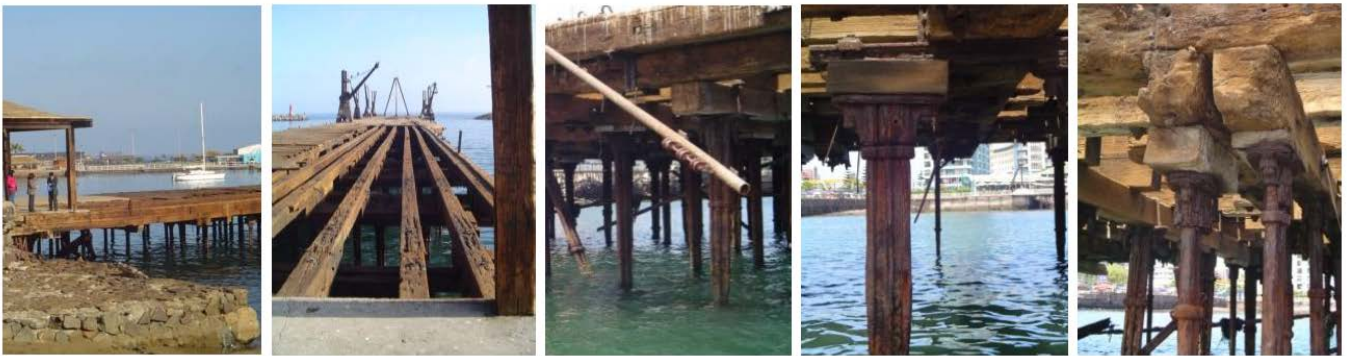
Primer tramo, estado previo a la restauración, 2005. (Fuente: Elaboración propia)
