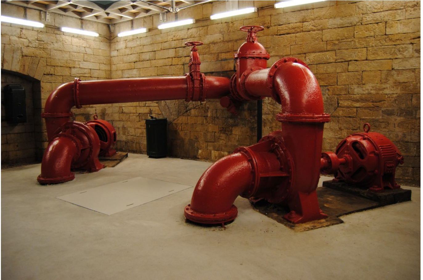
Bombas y tuberías de impulsión en el foso de la casa de bombas. 2014. (R. Suárez)
