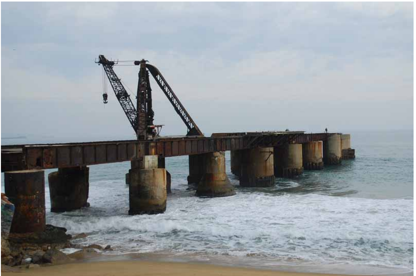
Imagen del Muelle Vergara en estado de abandono y con riesgo de derrumbe, 2010. (Fuente: http://valparaiso.mop.cl/noticias/PublishingImages/Web_Muelle.jpg )
