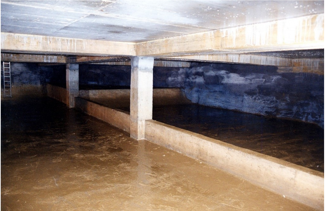
Tanque de tormenta. (Foto Universidad de Cantabria)
