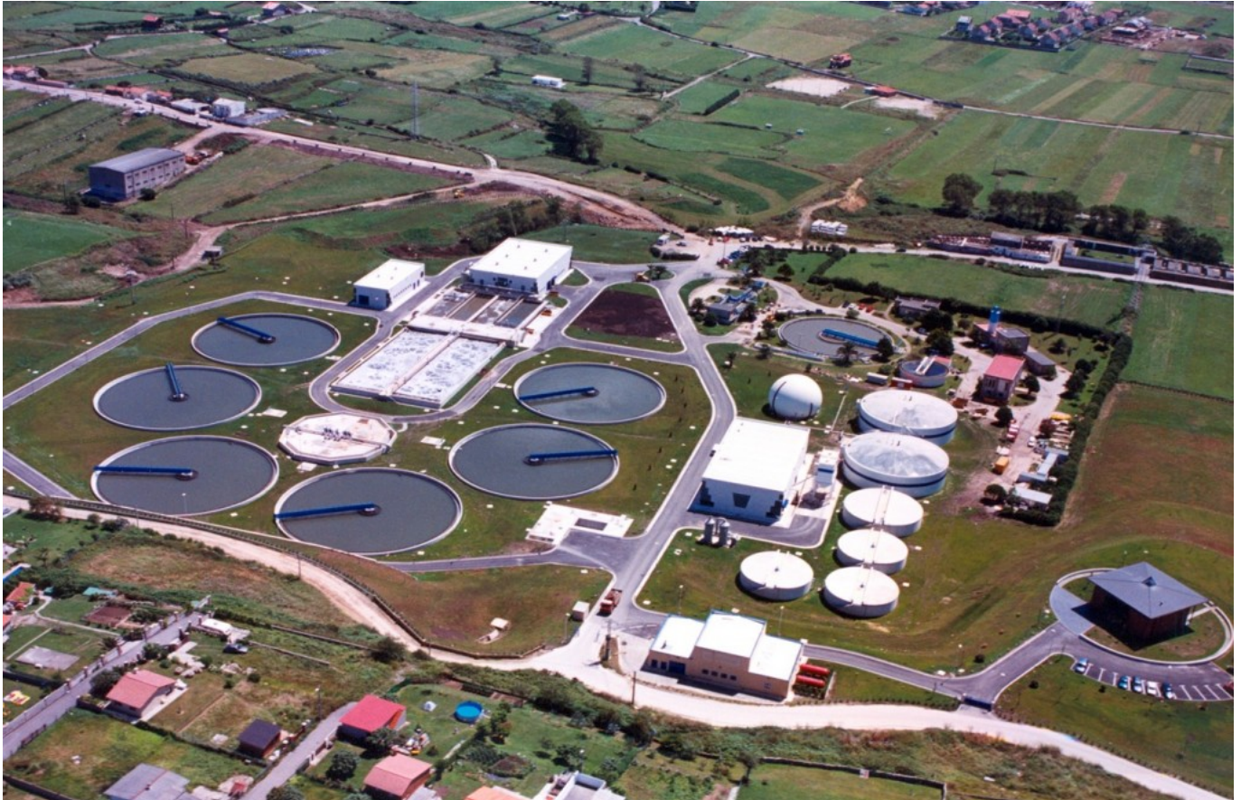
Estación Depuradora de Aguas Residuales. (Foto Universidad de Cantabria)
