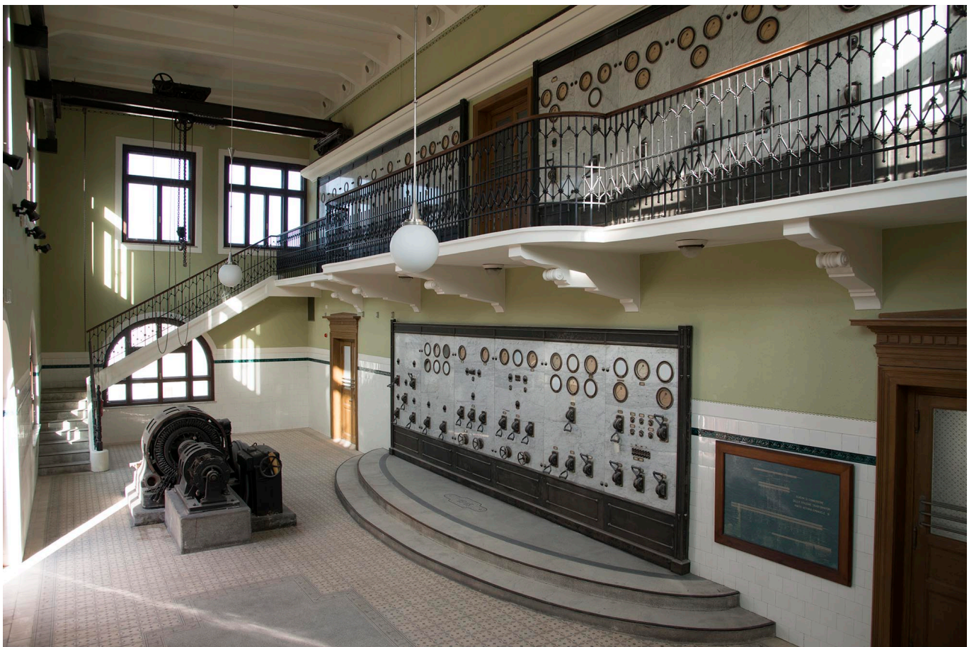
Porto Vecchio di Trieste: la sala quadri della Sottostazione elettrica di riconversione. (Foto: Neva Gasparo)
