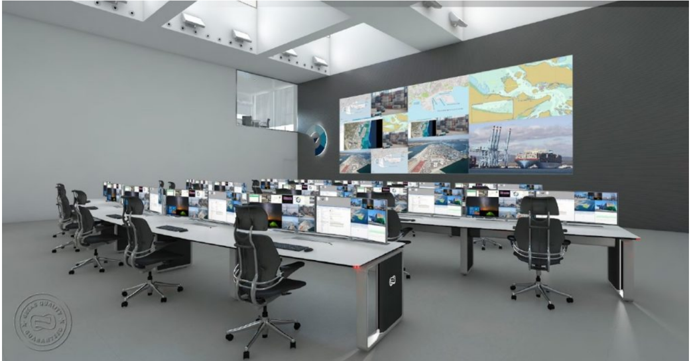
Centro de Coordinación de Procesos de la APBA junto con la Plataforma de Orquestación de Operaciones. (© Autoridad Portuaria de la Bahía de Algeciras - APBA, 2021).
