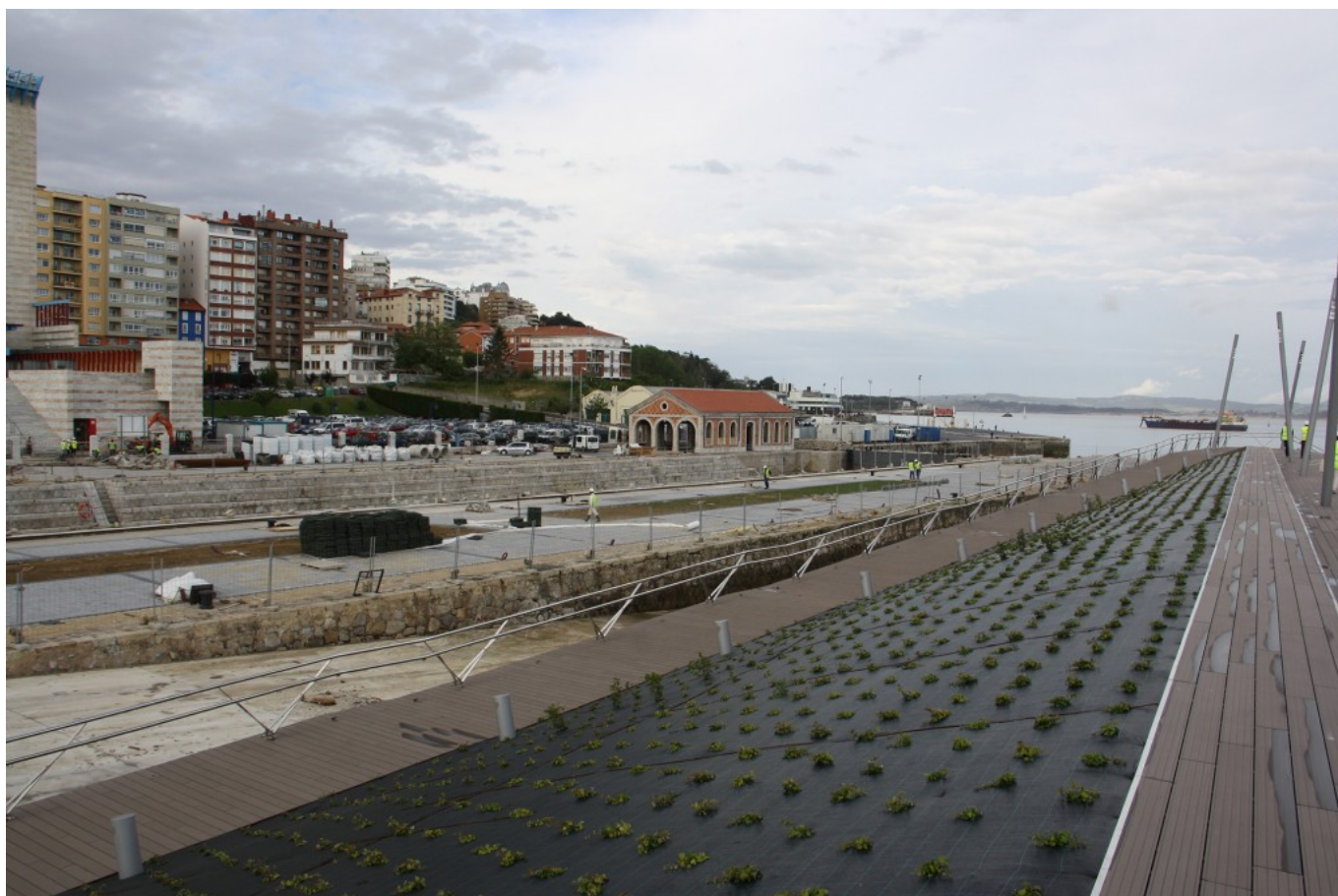
Trabajos de rehabilitación del entorno del Dique de Gamazo Estado, mayo 2014. (Foto: Román R. Luna)
