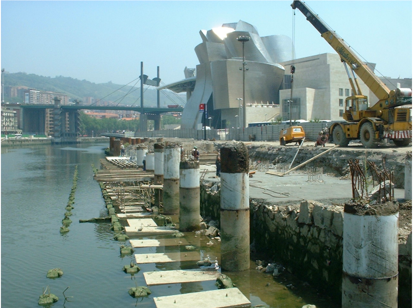
Obra de recorte del muelle en Abandoibarra (imagen de la antigua cimentación y de la nueva estructura)
