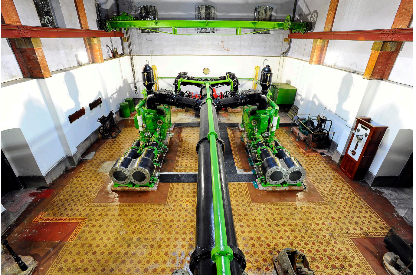
Maquinaria de vapor de la Casa de bombas de Elorrieta, del saneamiento de Bilbao de 1900, tras su recuperación. (© Santiago Yaniz, 2014).
