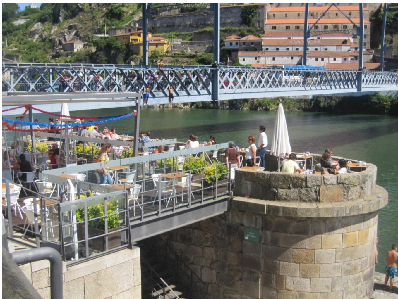
Pilar da Ponte Pênsil e tabuleiro inferior da Ponte D. Luis I.
